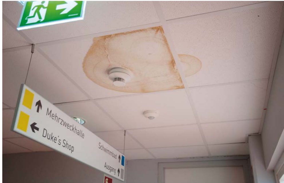
Abbildung 5: Wasserflecken an Decke
