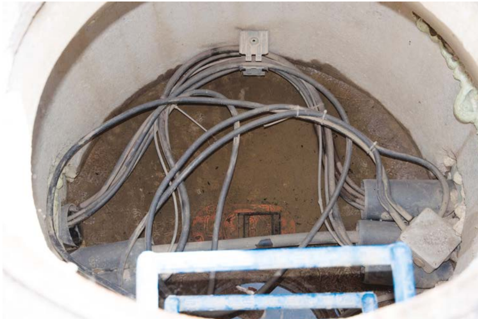
Abbildung 2: Kanalputzschacht und zugleich Kabelzugschacht
