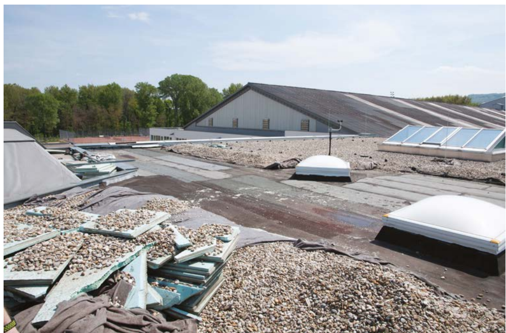
Abbildung 6: Dach abgedeckt mit losen Dämmplatten
